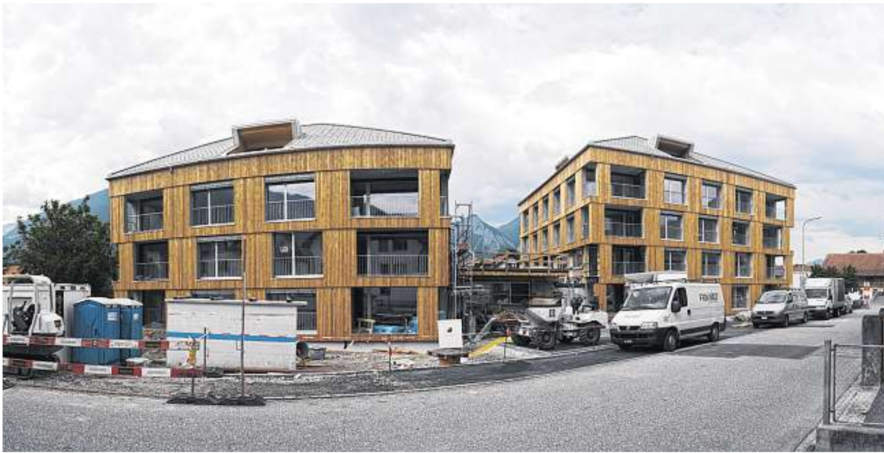
Vor der Fertigstellung: In Bonaduz entsteht das erste genossenschaftliche Projekt im Kanton Graubünden für das Wohnen im Alter von 55+.
